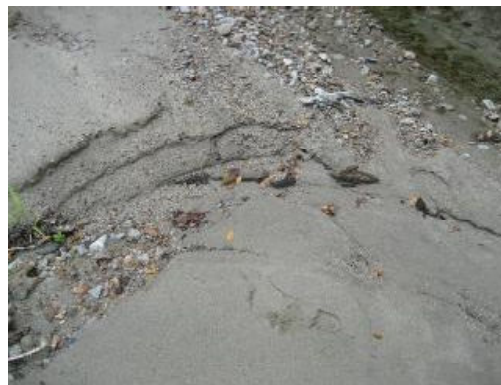
水流による侵食跡が見られる
