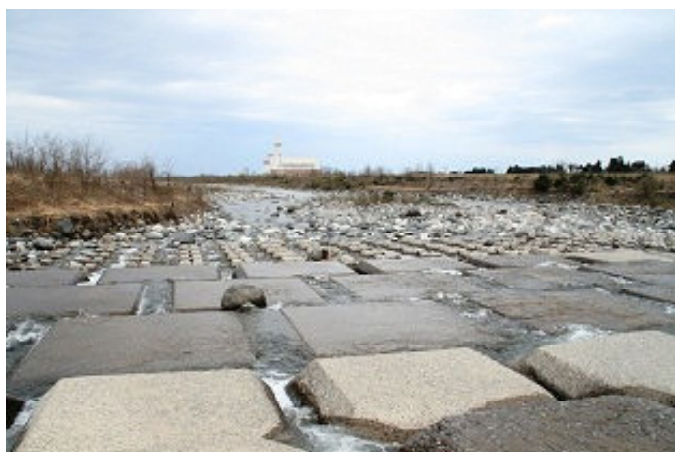
左岸から中州へ容易に移動できる。 (この四角いコンクリートのパーツの集合体を 「床止工」とよびます)
